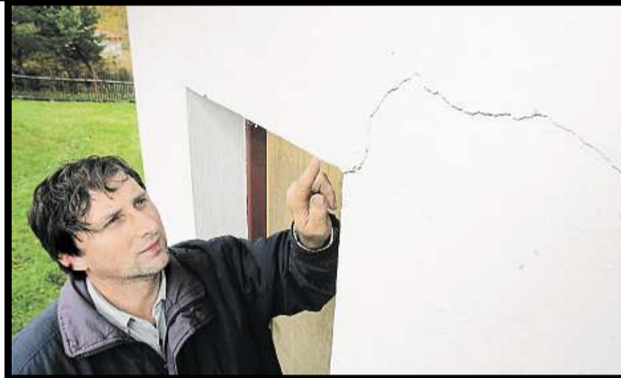
Následky Čtyřmetrová puklina na domě v Sindelově na Sokolovsku, která vznikla po jednom z otřesů. Foto: Lukáš Kuběna, MAFRA
