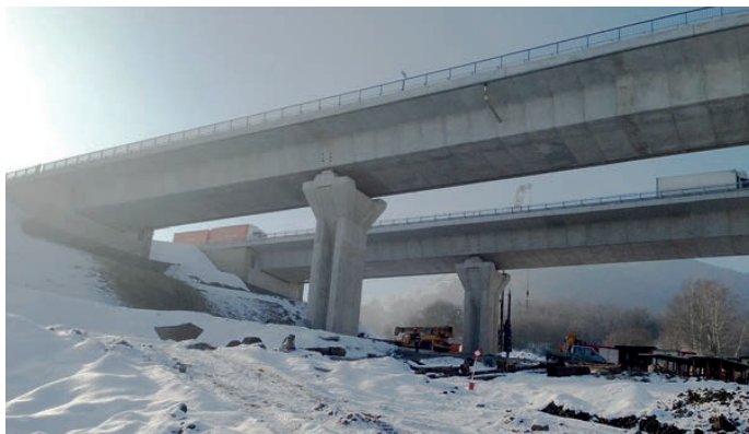
Uhasení jednoho ložiska požáru neznamená, že je po ohni. Dalším problémem D8 je jen o pár set metrů dál Prackovická estakáda. Bližší sloup se boří a naklání. Tedy další peníze navíc.
